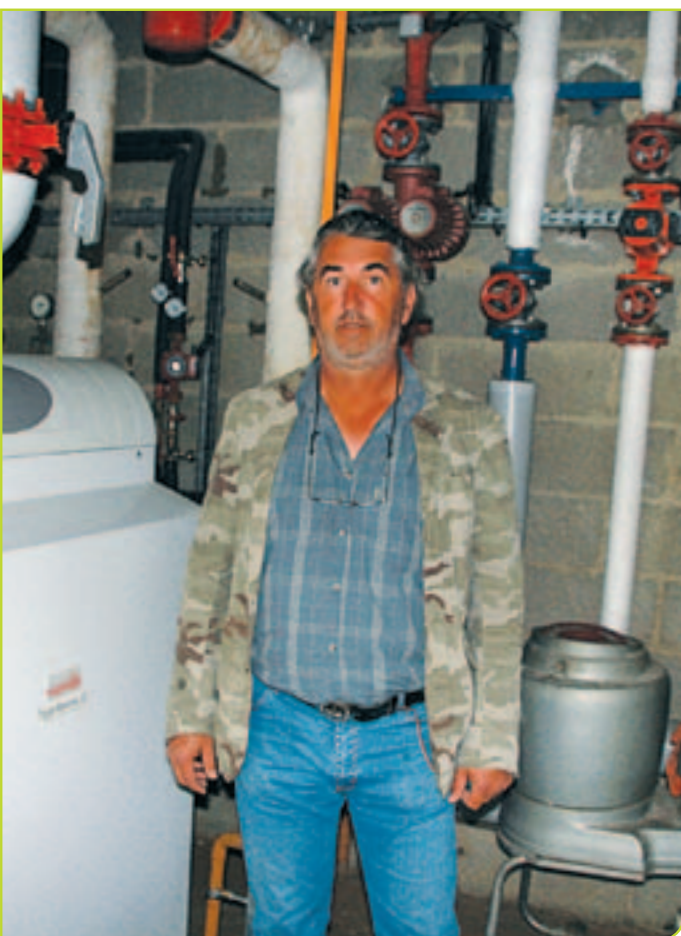
Régis Bouisson, technicien travaux aux services techniques municipaux, inspecte la chaudière gaz à condensation installée à l'école Jules Verne.
