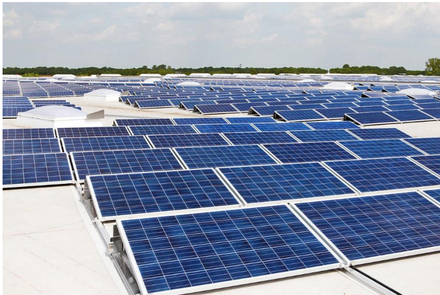
Illustration n°26 : Capteurs solaires photovoltaïques en toiture (source : Wikipédia)
