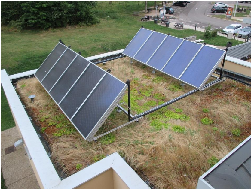
Illustration n°25 : Capteurs solaires thermiques sur toitures végétales (source : Wikipédia)
